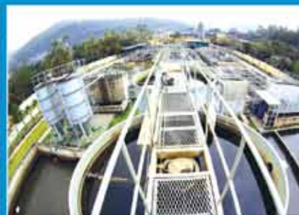
Trạm xử lý nước thải mỏ Và Dành
